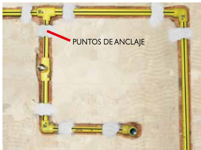
Vista parcial de instalación.
